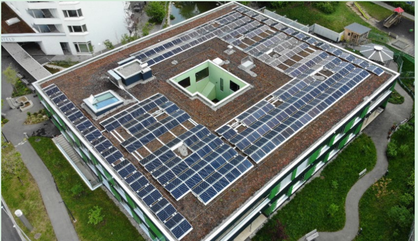
Solarstromanlage von suhrsolar auf dem Dach des «Hauses am Teich», Pflegezentrum Lindenfeld
