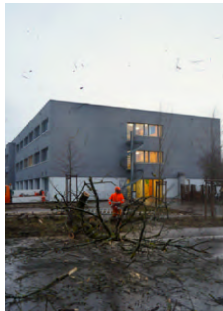
Der kranke Nussbaum im Fallen.
