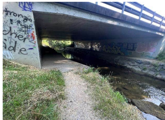
Abb. 3.2 Verortung 29, 30, 31 Der Bachdurchlass ist stark verbaut (Foto: SKK, 29.06.2023)
